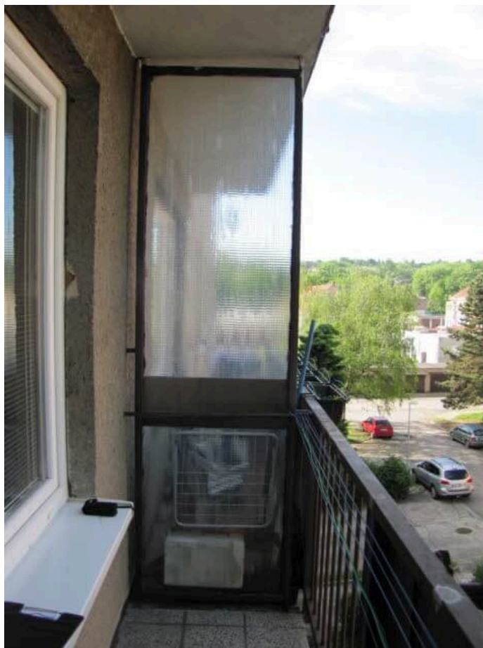
foto /6/ Původní stav balkónů.
