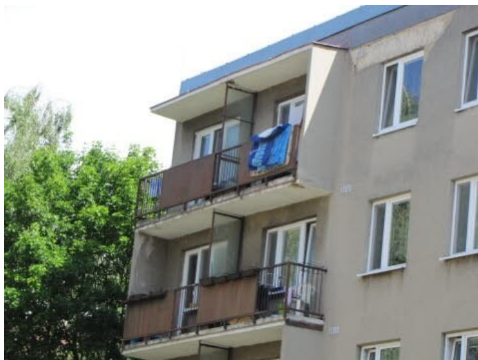
foto /5/ Původní stav balkónů.
